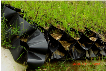
图 2 土工格室剪切破坏 Fig.2 Shear failure of geocell
